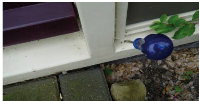
Houtrot. Houd hiermee rekening bij handhaven van bestaande kozijnen.
